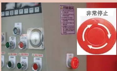
非常時の緊急停止ボタン
